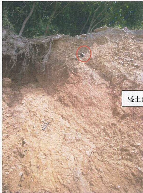
写真-3 管理用道路の造成による盛土崩壊：赤枠に塩ビ管
