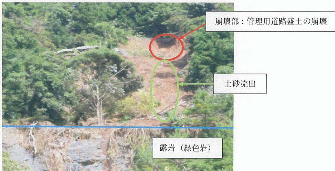
写真-2 崩壊の状況（熊谷組 7/13 撮影）
