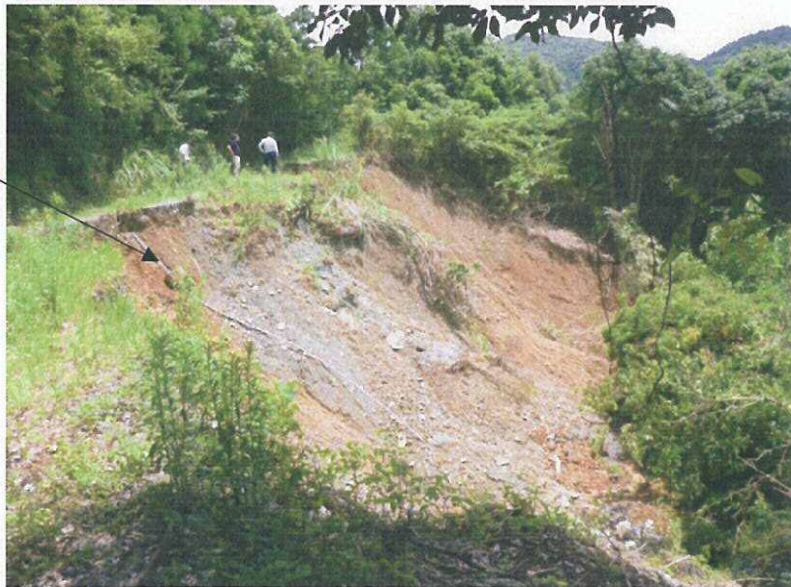
写真-5 盛土崩壊部の状況（熊谷組 7/13 撮影）：斜面方向に塩ビ管が伸びている。
