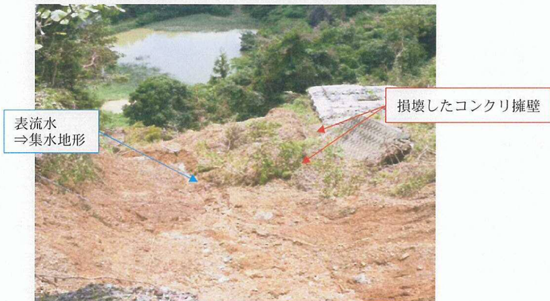
写真-4 土砂流出とコンクリート間知擁壁の損壊状況（熊谷組 7/13 撮影）
